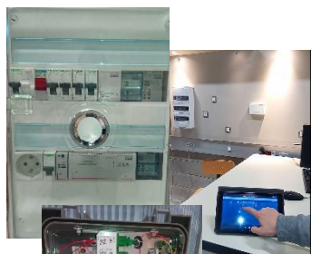
Réseau VDI Maison connectée Fibre Optique
